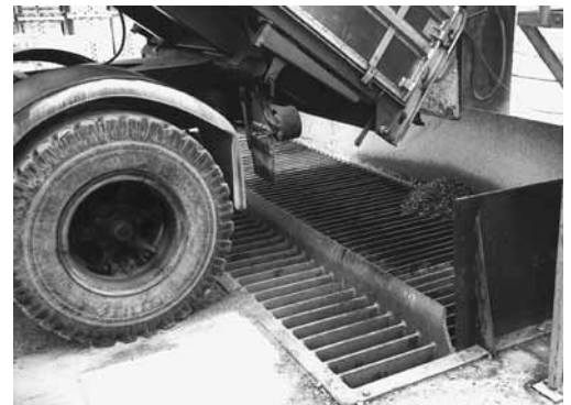
Bild 10: Beschickungsöffnung mit Rost, den das Bedienungspersonal nicht betreten muss. Die Abstände zwischen den Längsstäben dürfen nicht mehr als 80 mm betragen. Sind Längs- und Querstäbe vorhanden, dürfen die Öffnungen zwischen den Stäben höchstens 150x150 mm gross sein.
