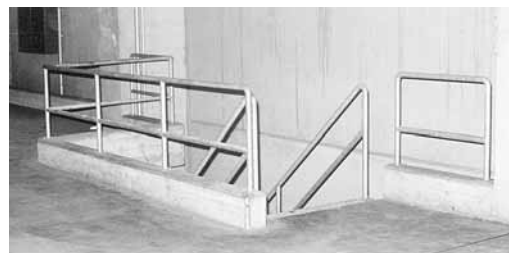
Bild 1: Treppenabstieg, allseits mit Geländern umwehrt. Die stark bemessene Bordleiste verhindert Beschädigungen durch Fahrzeuge.
